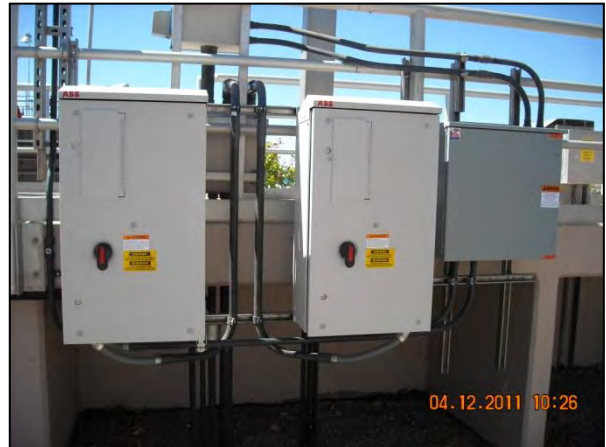
Effluent Pumps VFDs
